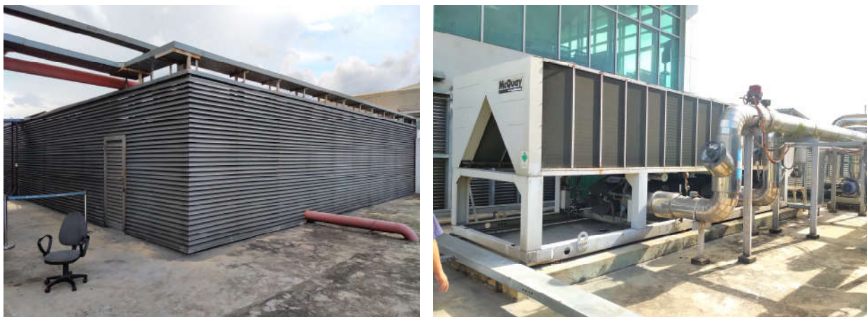
Hình 2.16. Nhà cơ điện M&E
