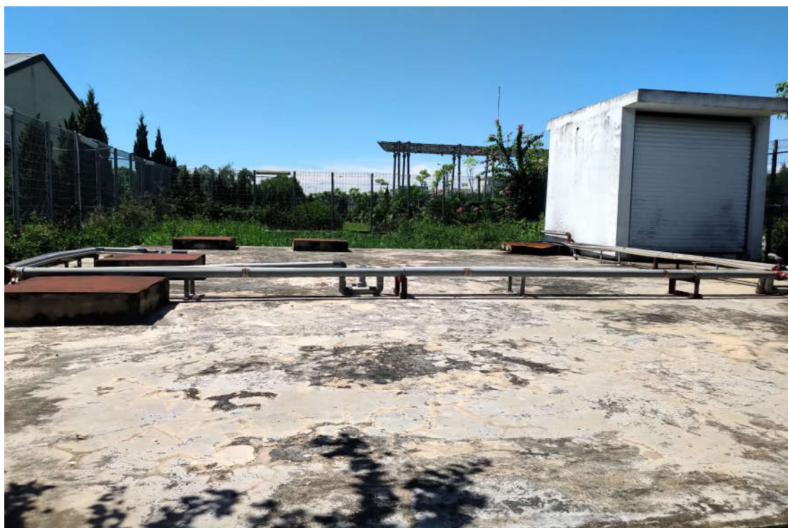
Hình 2.22. Trạm xử lý nước thải
