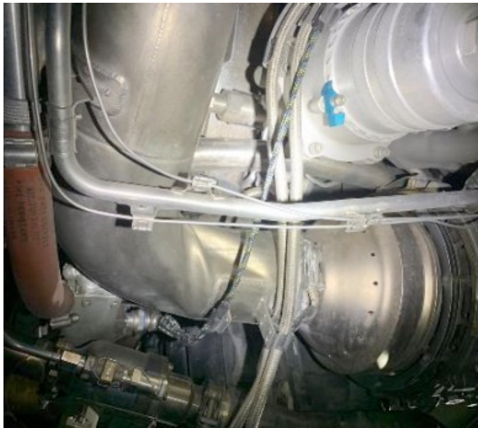
Hình số 01. Đường ống dẫn của bộ khởi động khí bị xoắn
