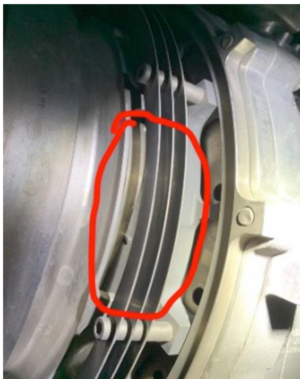
Hình số 02. Tua-bin khởi động khí bị hư hỏng.
