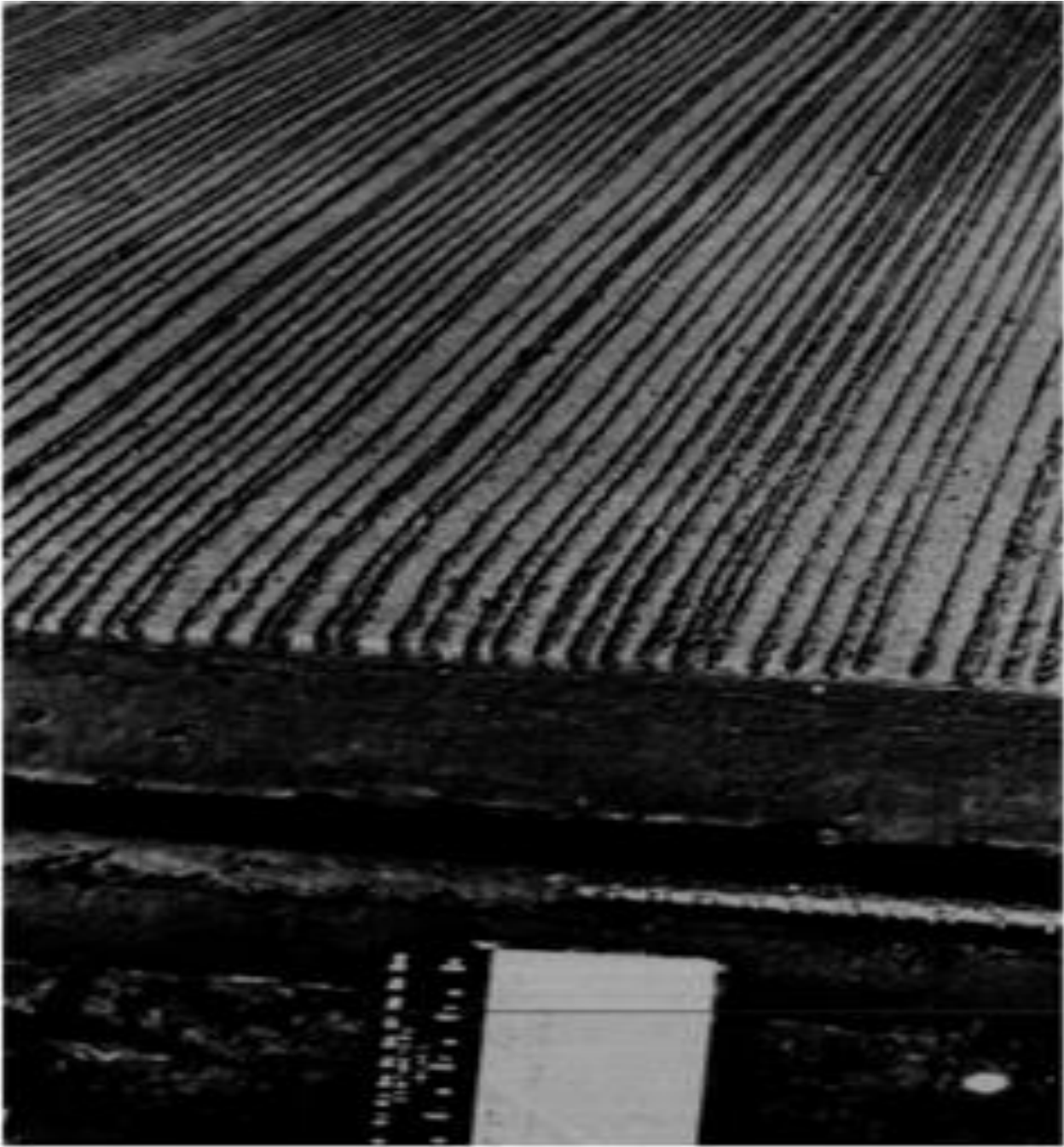
Hình 5 - Hình ảnh bề mặt mặt đường sau khi được tạo nhám bằng kết cấu kỹ thuật wire comb tại sân bay Patrick Henry, Virginia với cấu trúc sử dụng 1/8 inch x 1/8 inch x 1/2 inch
